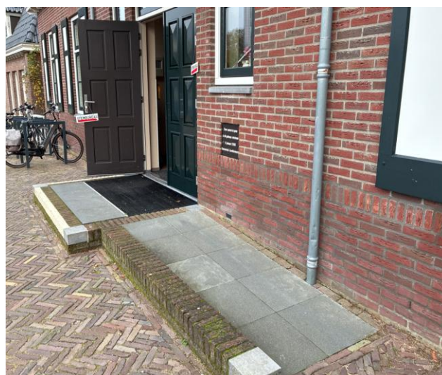
Een oprit naar een plateau waar erg weinig manoeuvreer-ruimte is, met het risico om bij het manoeuvreren van het plateau te raken.
