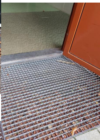
Een rooster dat niet is afgedekt.
